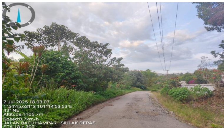
Gambar 4 Kondisi Jalan Di Desa Siulak Deras, Kabupaten Kerinci
