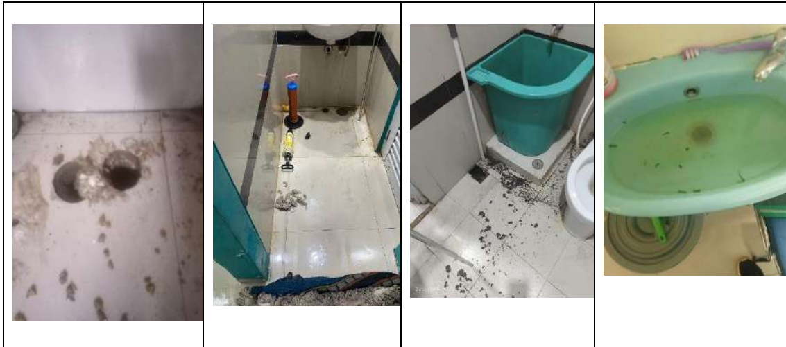
Gambar 3.3 Toilet dan Wasthafel tersumbat
