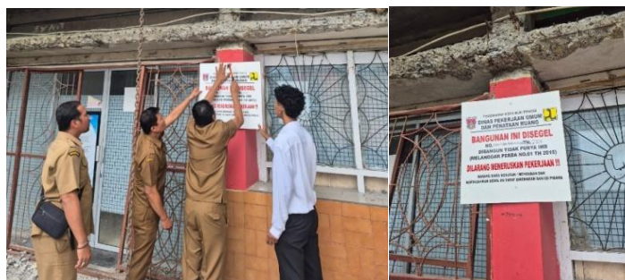
Gambar 3. 2 Penyegehan Bangunan Tanpa IMB tahun 2025
