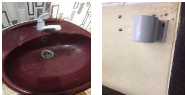
Gambar 3.3 Fasilitas Cuci tangan yang kurang memadai
